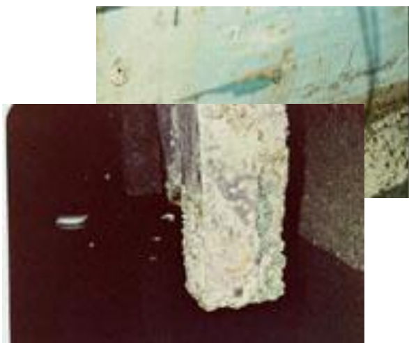
شکل ۴- تخریب انتهای مستقر در آب ضربه گیر چوبی در
